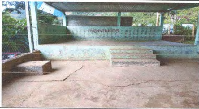
FOTO 1 DE REPARACION DE ESCENARIO POR FISURA EN SU ESTRUCTURA EN PELIBRO DE DESPROMARSE
